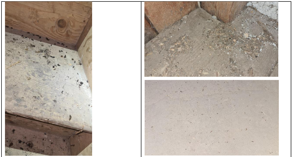
Abbildung 12: Spuren von Fledermäusen in den Bestandsgebäuden
